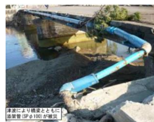
破損した添架管（仙台市宮城野区蒲生地内）
