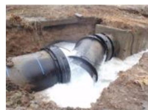
震災時の漏水（仙南・仙塩広域水道）
