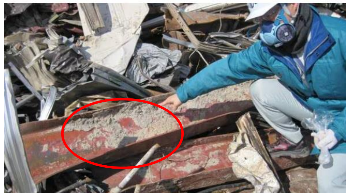
仙台市の災害廃棄物仮置場で鉄骨の吹き付け剤からアモサイト（茶石綿）がみつかった。出所は市による被災建物の公費解体現場。2012年1月のもの（情報公開請求で仙台市から井部正之氏が入手）：東洋経済オンライン2021年3月19日
